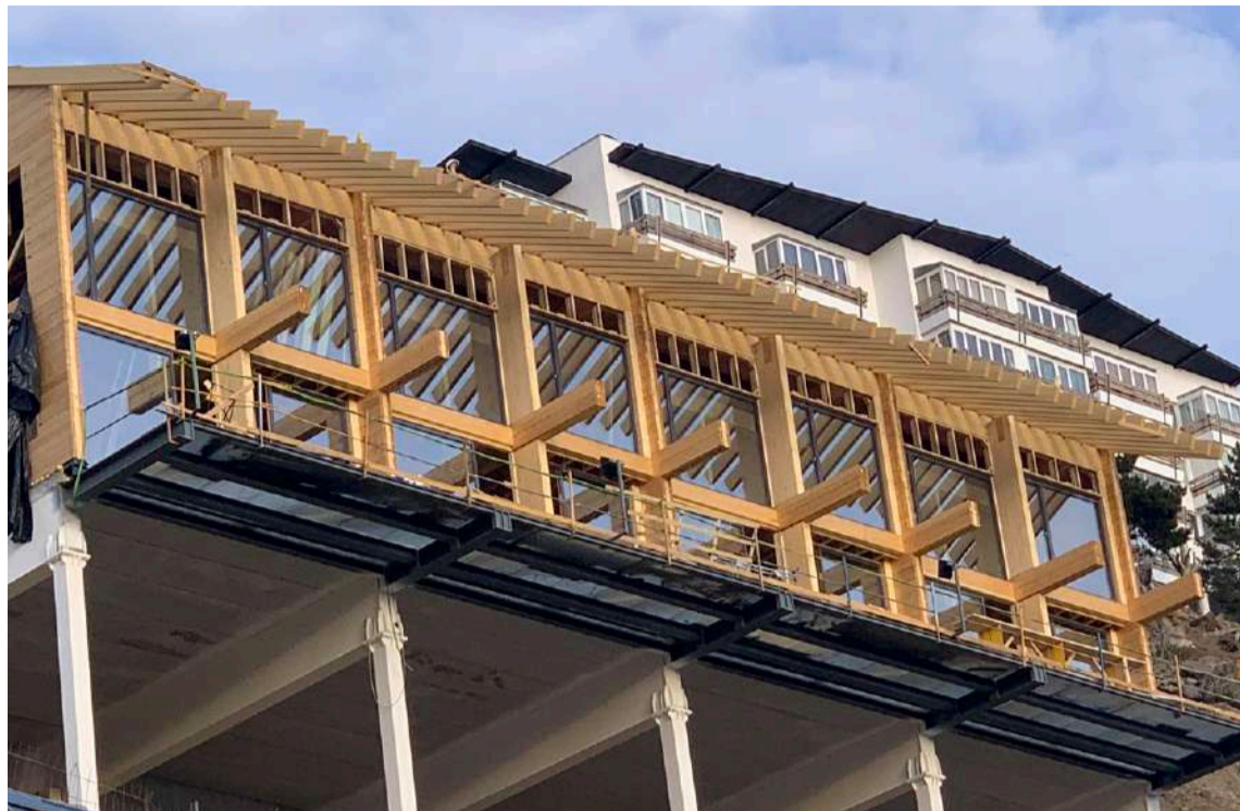
Imagen de las obras de las primeras cuatro viviendas que componen la promoción.
